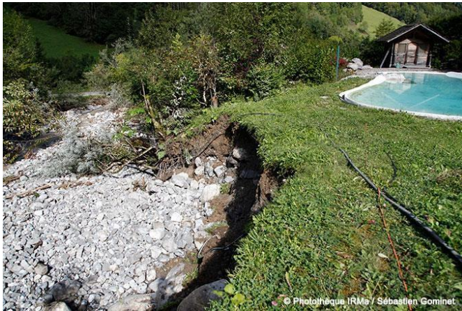
Sapement de berges suite à une crue torrentielle du torrent du Malnant dans la commune de Thônes, hameau de Montremont, septembre 2014. Source : IRMA
